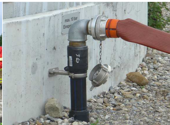
Die Feuerwehr kann ihren Schlauch am vorbereiteten Stützen hinab ins Tunnel anschliessen
